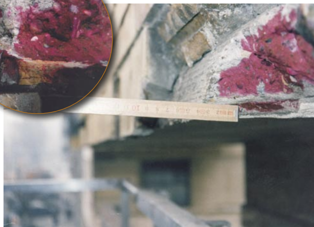
La profondità della carbonatazione può venire evidenziata attraverso la prova alla fenolftaleina.
