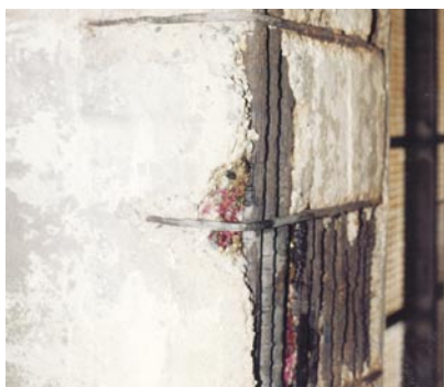
Particolare corrosione dei ferri di armatura di una colonna in cemento armato. L'espansione del ferro attaccato dalla ruggine provoca la distruzione e il distacco delle porzioni di conglomerato cementizio circostanti.
